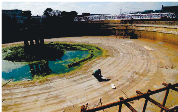
Рис. 1 Первичный отстойник на действующих канализационных очистных сооружениях до реконструкции
