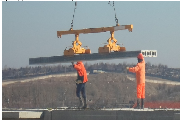
Рис.1. Обратный выгиб предварительно напряженной пустотной плиты в процессе ее монтажа траверсой с клещевыми захватами
