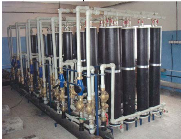
Рис. 4. Внешний вид станции. Мембранные блоки, общая подача – 100 м 3 /ч
