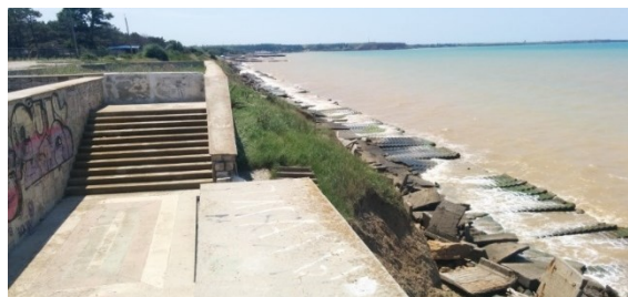
Рис. 7. Аварийное состояние откосных сооружений в районе с. Песчаное, Республика Крым
