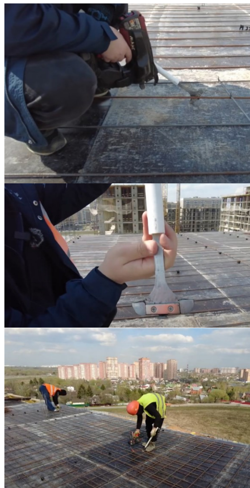
Рис. 4. Общий вид и последовательность технологических операций вязки арматурных сеток с использованием инновационного инструмента Fig. 4. General view and sequence of technological operations for knitting reinforcing meshes using an innovative tool
